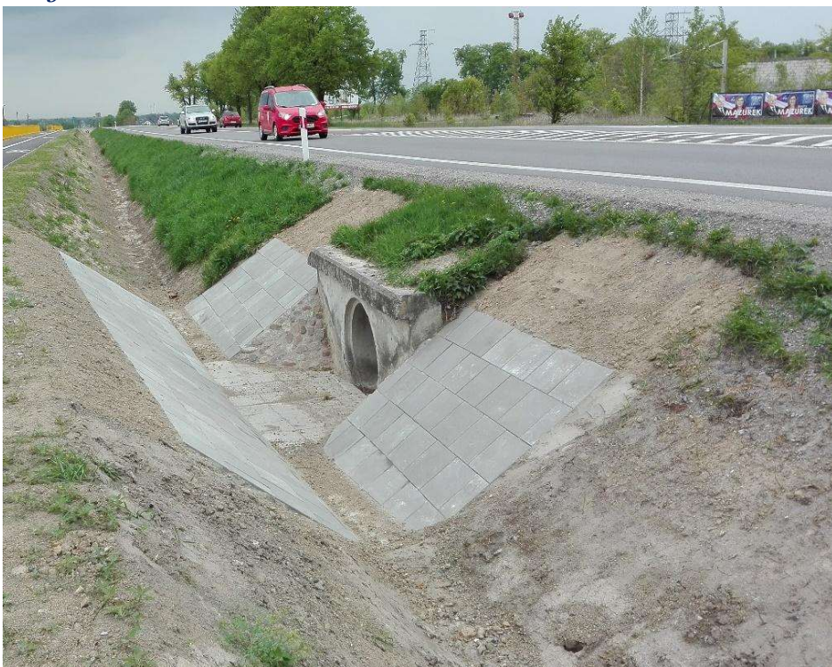
Zdjęcie 4. Elementy przepustu stanowiące zagrożenie przy wypadnięciu z drogi.
