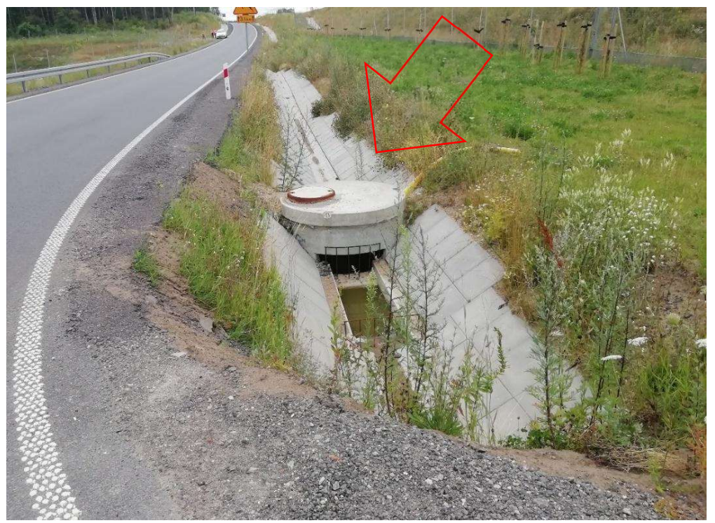
Zdjęcie 7. Studzienka i inne elementy odwodnienia stanowiące zagrożenie przy najechaniu na nie.
