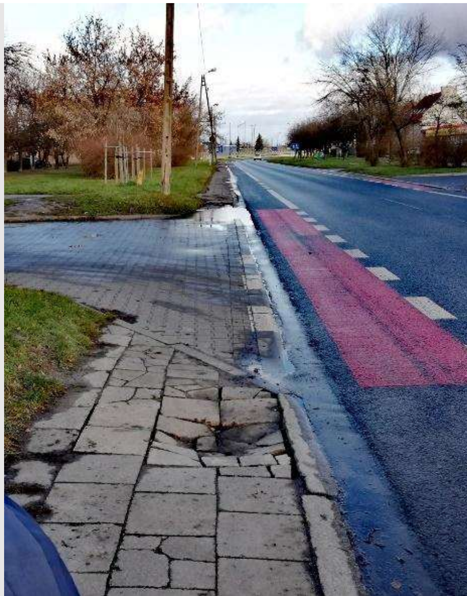
Zdjęcie 1. Wyremontowana ulica, wyznaczone pasy rowerowe, a chodnik pozostał. Przed zjazdem zapadnięty, za zjazdem „jezioro”.
