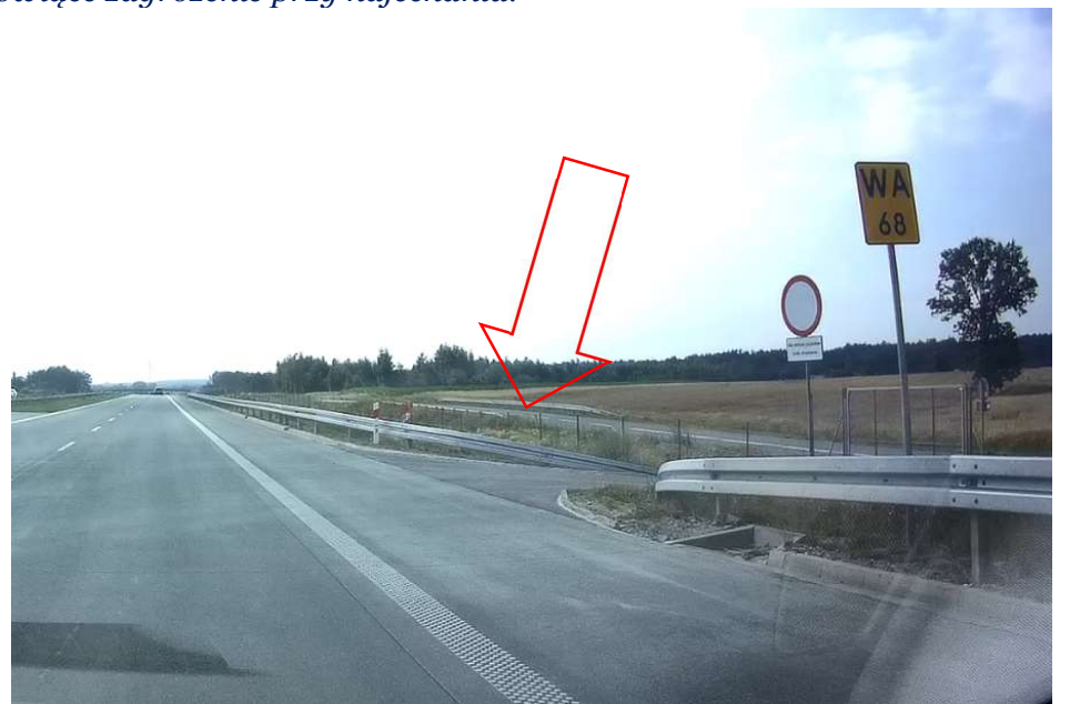
Zdjęcie 12. Ukształtowanie wjazdu awaryjnego stwarzające zagrożenie i bariera na wjeździe awaryjnym wykonana w sposób zagrażający bezpieczeństwu.
