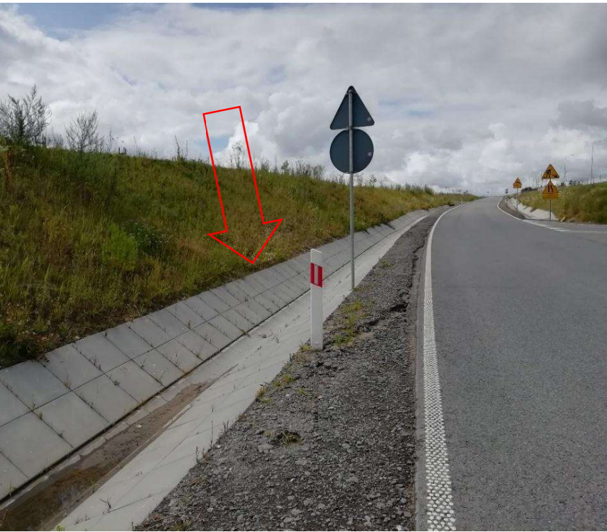
Zdjęcie 6. Utwardzony rów stanowiący zagrożenie przy zjechaniu z drogi.
