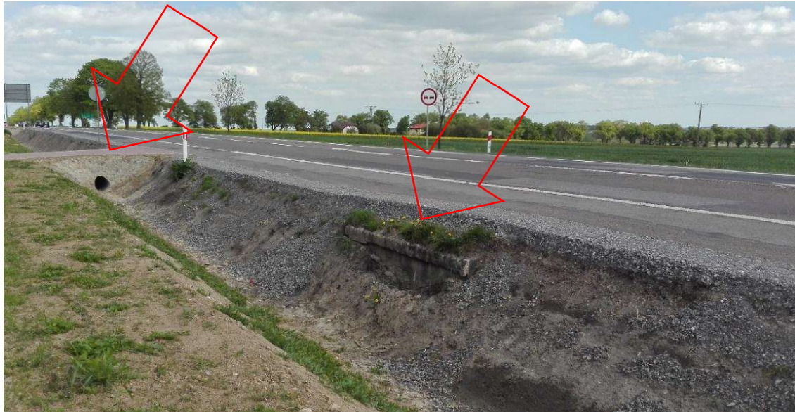
Zdjęcie 1. Betonowy element stanowiący zagrożenie przy wypadnięciu z drogi. Niosłonięta kamienna zabudowa przepustu.
