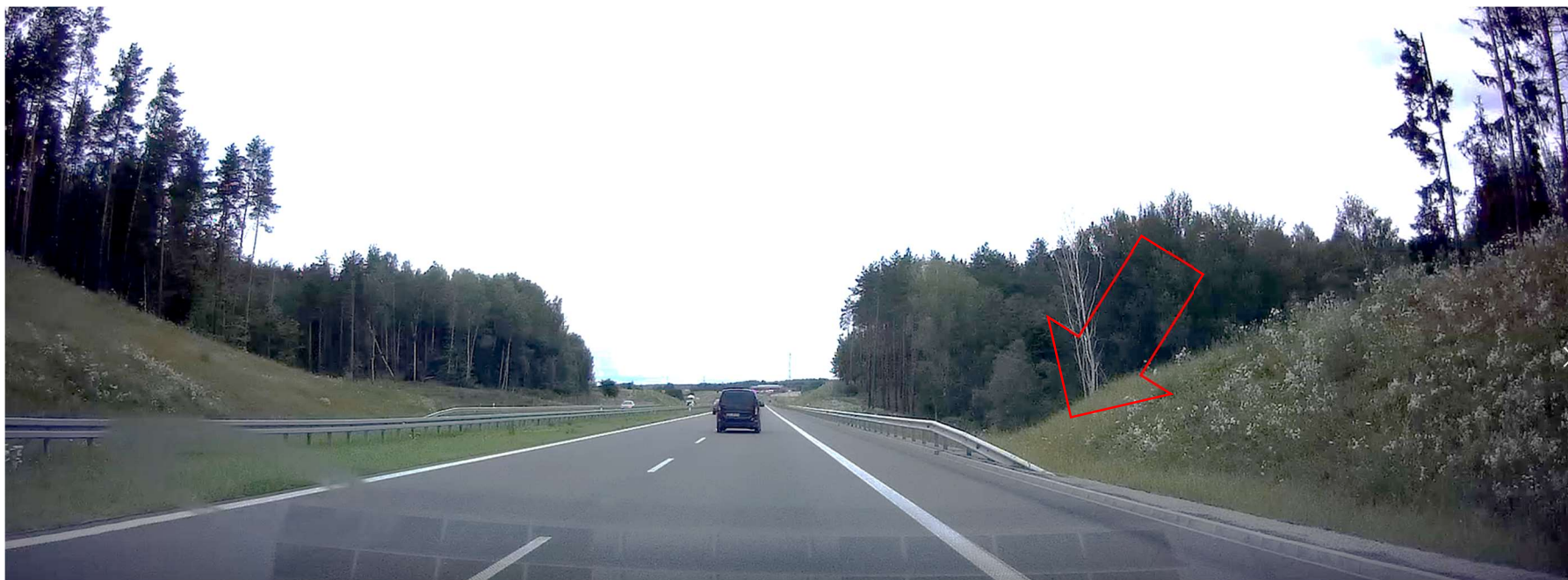
Zdjęcie 16. Zbyt wczesnie zakończona bariera nie zapobiega wpadnięciu w obniżenie terenu za barierą.
