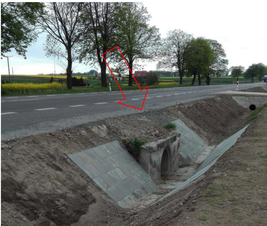
Zdjęcie 2. Elementy przepustu stanowiące zagrożenie przy wypadnięciu z drogi.
