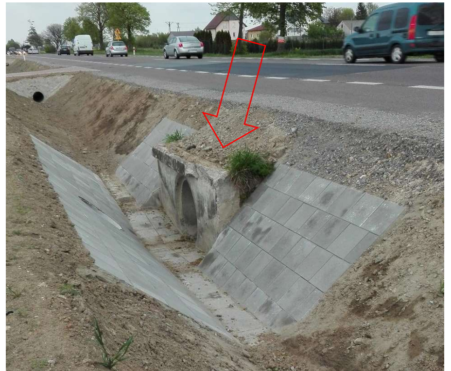
Zdjęcie 3. Elementy przepustu stanowiące zagrożenie przy wypadnięciu z drogi.
