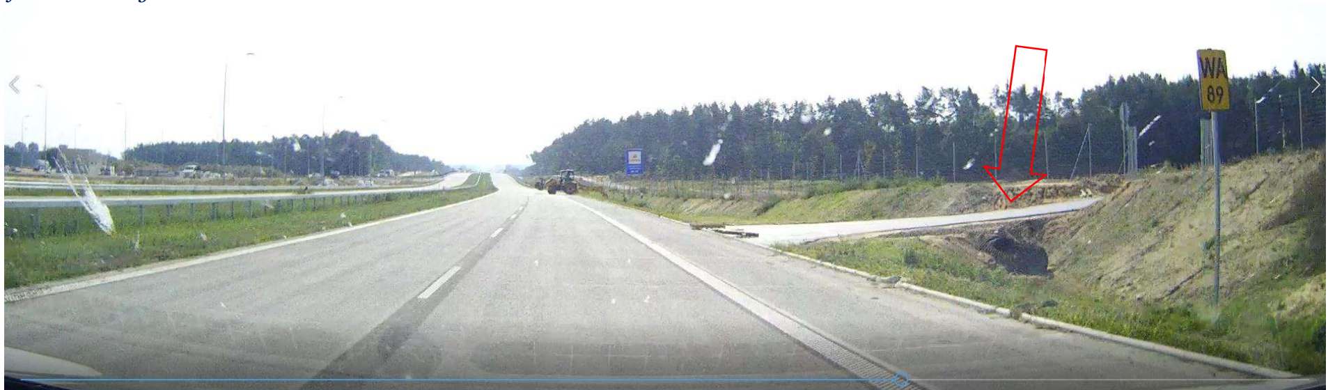
Zdjęcie 10. Elementy odwodnienia w otoczeniu drogi ekspresowej stanowiące zagrożenie przy najechaniu.
