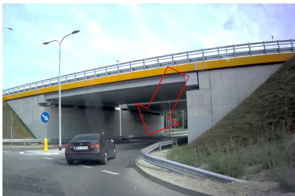
Zdjęcie 14. Bariery w skrajni drogowej.
