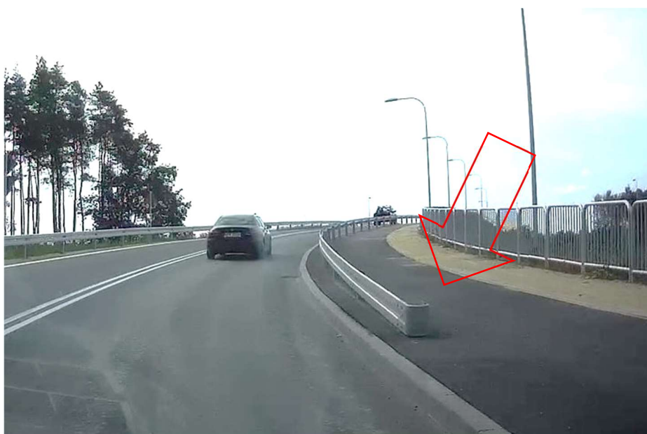
Zdjęcie 13. Nieprawidłowo wykonany początek bariery, zagrażający bezpieczeństwu.
