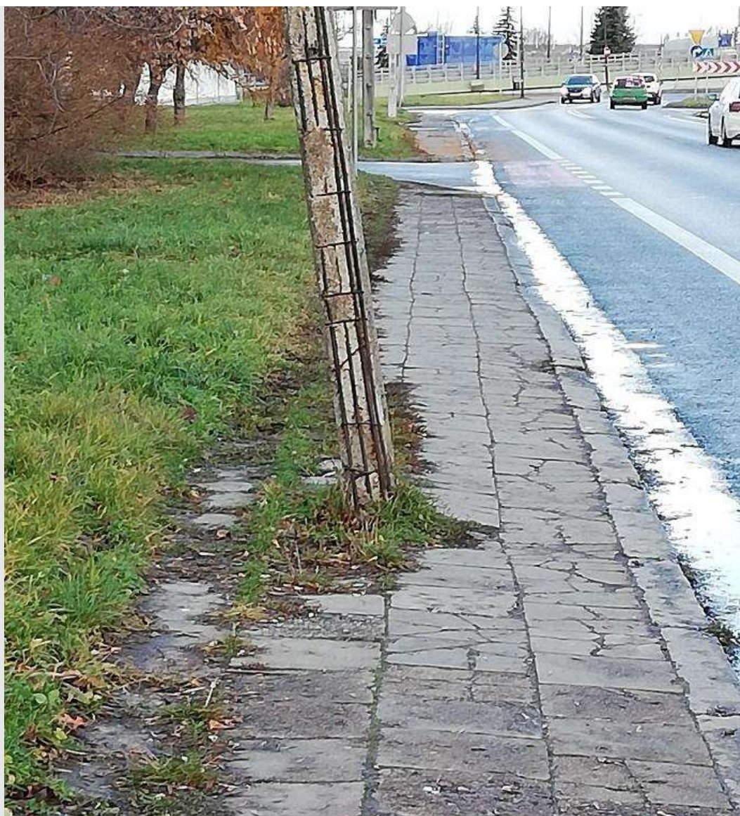
Zdjęcie 4. Dwie płytki chodnikowe i krawężnik! Brak odpowiedniej szerokości chodnika umożliwiającej przejście.
