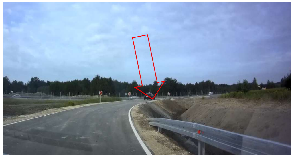
Zdjęcie 9. Zbyt wcześnie zakończona bariera – nieosłonięty rów.
