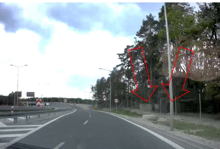
Zdjęcie 11. Nieosłonięta studzienka i słup oświetlenia w otoczeniu drogi.
