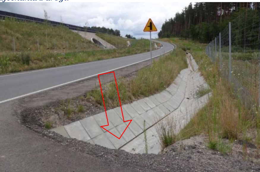
Zdjęcie 8. Utwardzony rów stanowiący zagrożenie przy zjechaniu z drogi.
