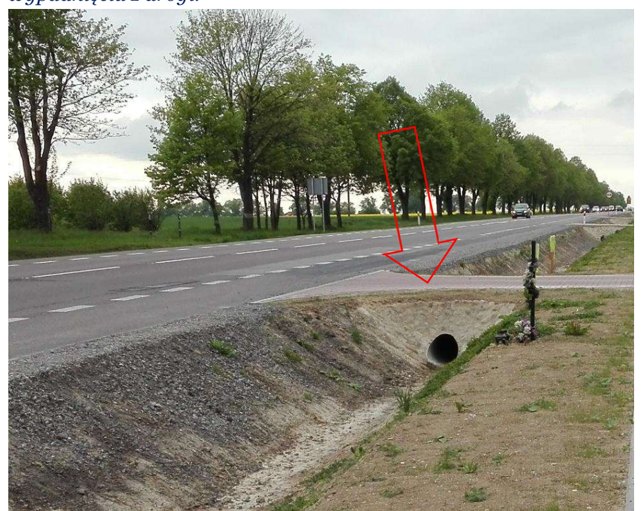
Zdjęcie 5. Elementy przepustu stanowiące zagrożenie przy najechaniu na nie.
