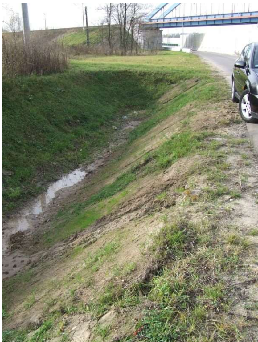
Zdjęcie 10 Nieosłonięty głęboki rów.
