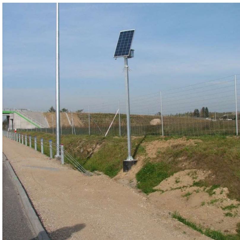
Zdjęcie 5 Zbyt wcześnie zakończona bariera. Nieosłonięta konstrukcja wsporcza baterii słonecznej. Nieosłonięty, głęboki rów o stromych skarpach
