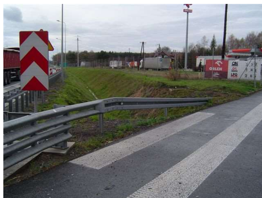
Zdjęcie 11 Nieprawidłowo wykonana bariera. Nieprawidłowo osłonięty głęboki rów przy wjeździe na MOP. Odcinek końcowy bariery w miejscu, gdzie powinna być bariera.
