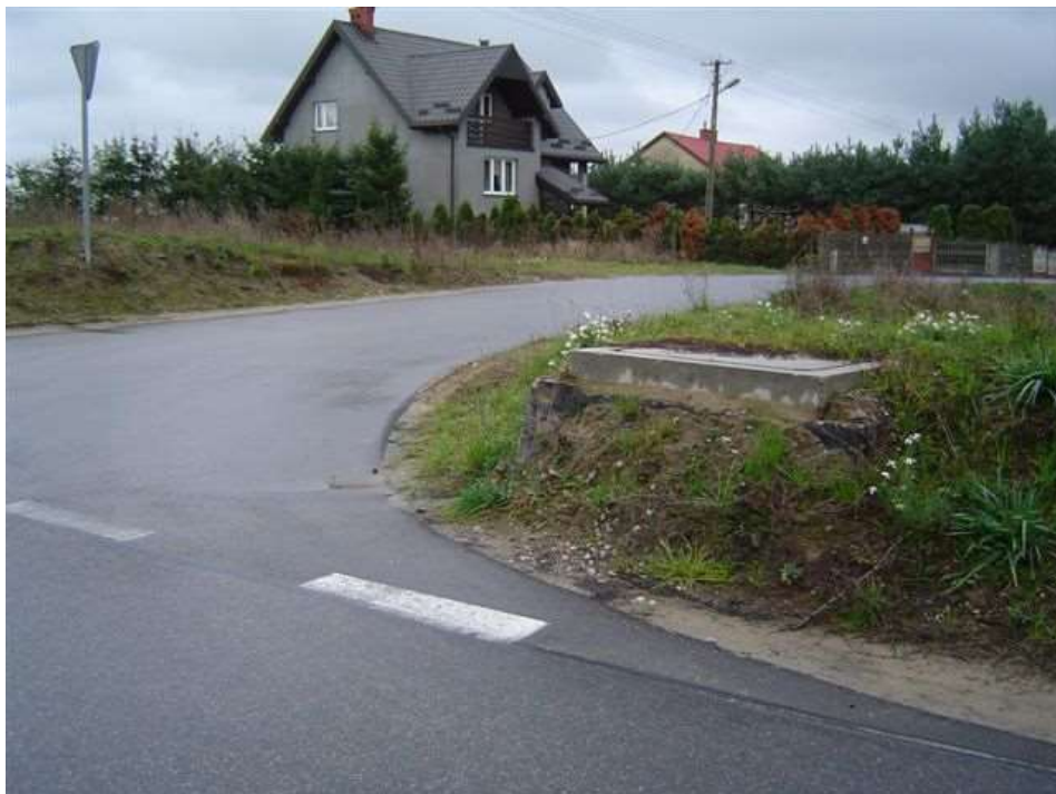
Zdjęcie 1 Wystająca studzienka na łuku do skrętu w prawo na skrzyżowaniu.
